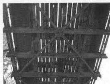
写真-3 補修前の床版の状態
